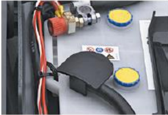
SmartCharge-Anschluss mit Sicherung direkt auf dem Batteriepol des Zugfahrzeugs.
